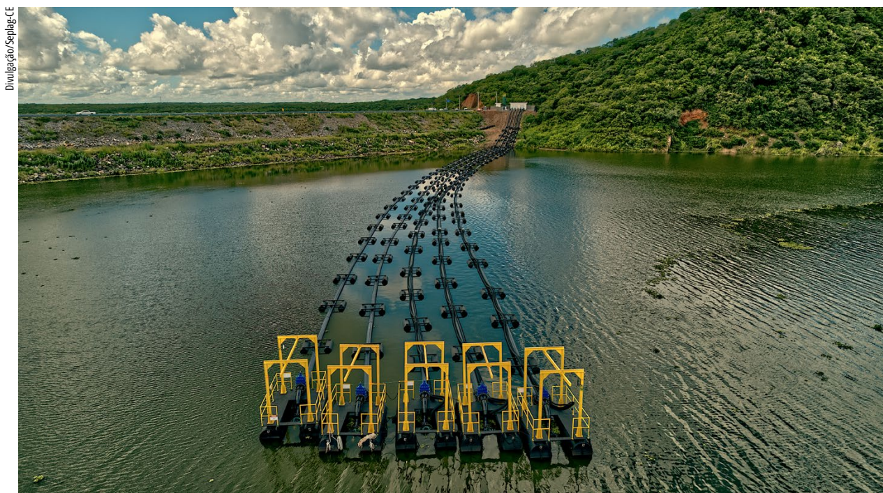
Captação flutuante do Malha D'Água: tecnologia que garante água tratada diretamente dos reservatórios para 5,6 milhões de cearenses
